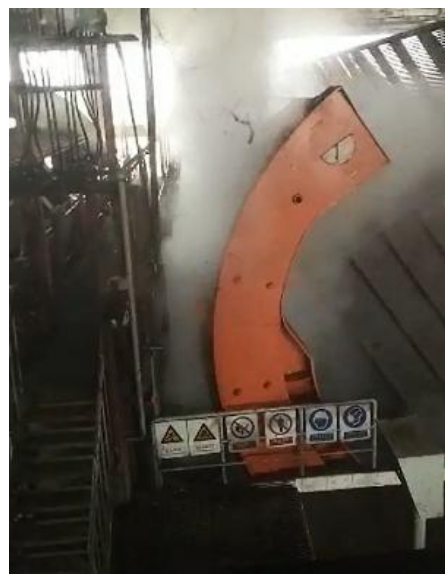
项目现场微雾抑尘系统运行
