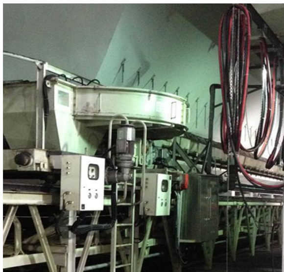
水气管线自动跟踪装置
