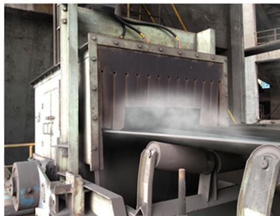
项目现场治理点微雾抑尘系统运行
